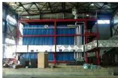
Slika 1. Izgled vrelovodnog kotla ERK – RH30
