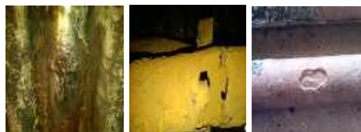
Slika 6. a) Ošte enje zida memembranske cevi prednjeg ekranskog dela i b) Izgled ošte enog duva a gareži, c) Ošte enje cevi eko-paketa
